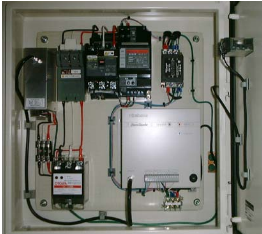
対雷自動ブレーカ（内部）
